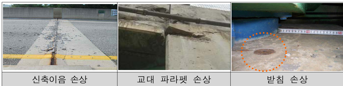
교대 수평변위 발생 시 손상 유형
